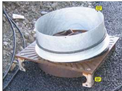
TOPPLATE PÅMONTERT STØTTEBEN (IKKE ORIGINALT)
